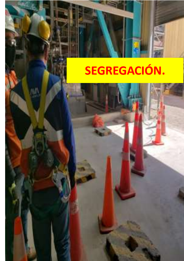
INSPECCIÓN DE SEGREGACIONES DE ÁREA DE TRABAJO Y EL RESPETO HACIA ESTAS.
